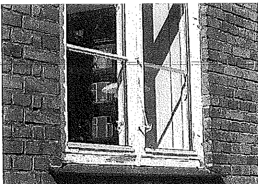
Vindue(gadeside) med afskallet maling
