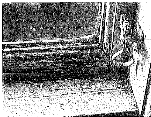
Vindue(gadeside) hvor bundliste bør udluses
