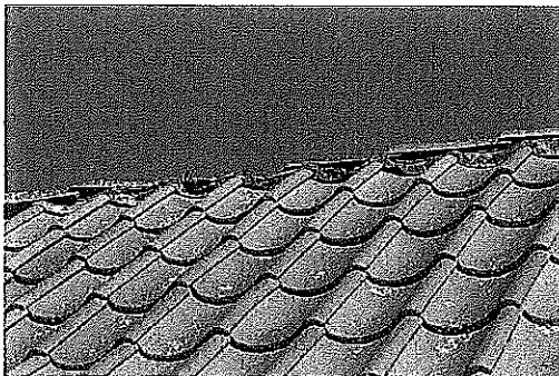
Tagrygning ligger dårligt
