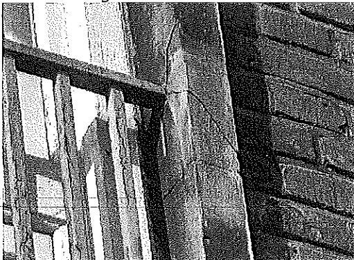
Skade på dørramme ved fransk altan/værn
